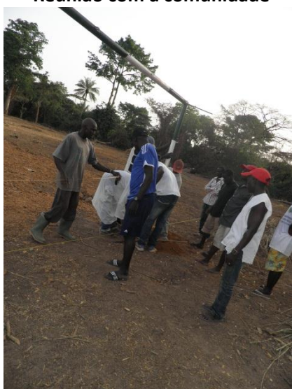
Alinhamento do campo
