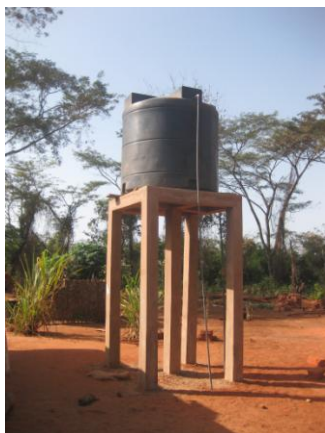
Depósito elevado de água e respectiva canalização
